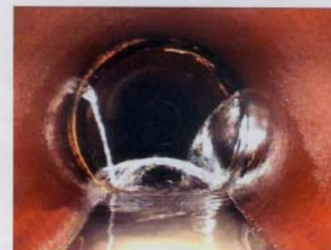
Fremdwasserzutritt, Foto: Stadtentwässerung Freiburg
