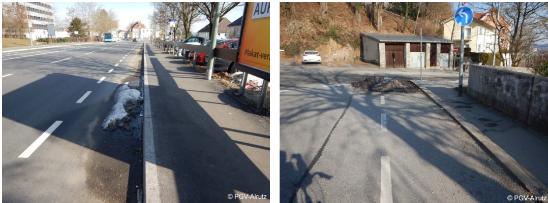
Abb. 6-31: Negative Beispiele Winterdienst auf der Neuburger Straße (links) und Vilshofener Straße (rechts)
