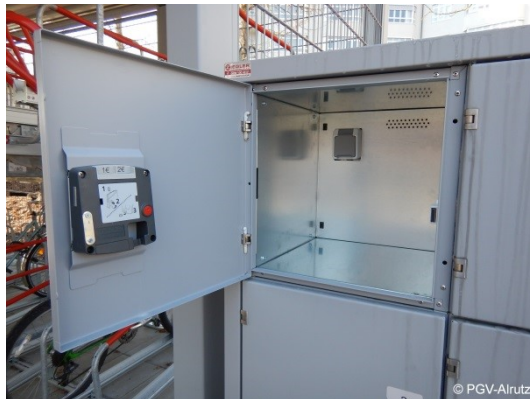
Abb. 7-13: Doppelstockanlage am Klinikum Passau
