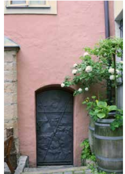
Fassade mit Streichputz verwaschelt
